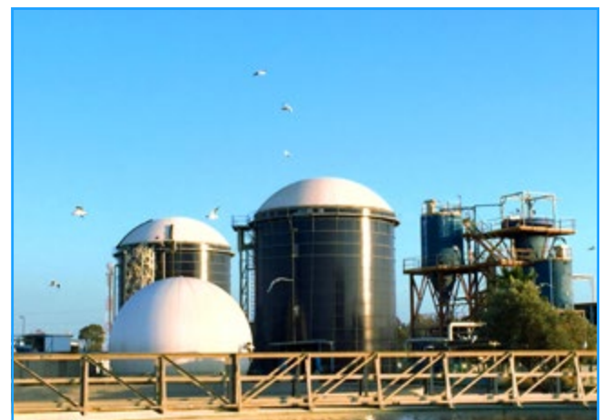
Die Kläranlage Hadera
