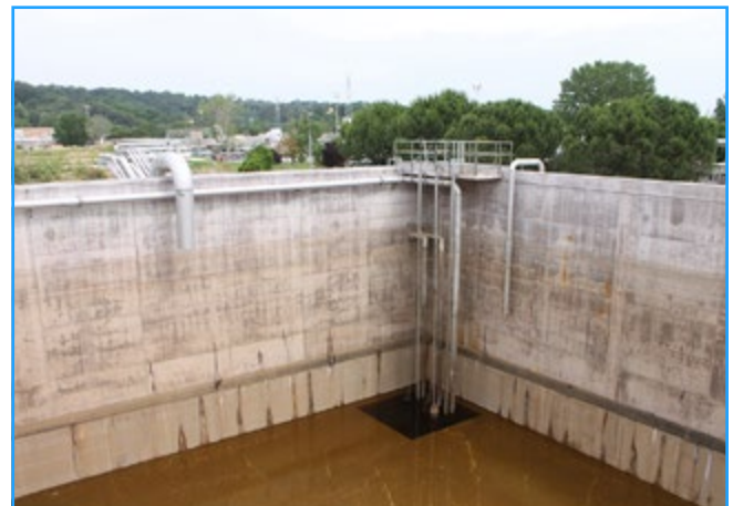
Zwei der Becken der Aufbereitungsanlage, in denen die Geräte von Zenit installiert sind.
