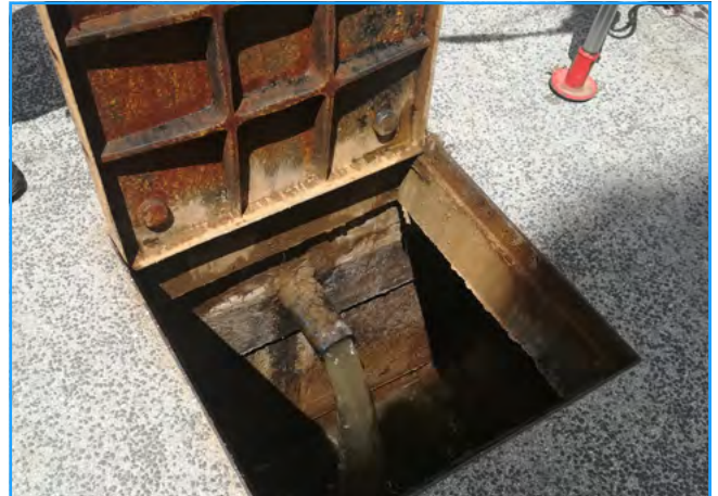
Das zu hebende Abwasser
